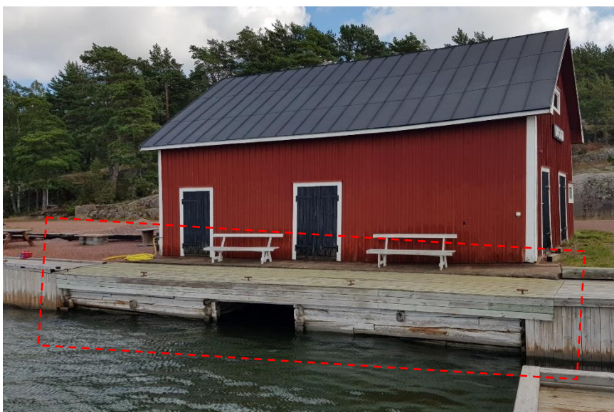
Bild 1. Befintlig bryggdel som håller på att rasa ut i vattnet.
